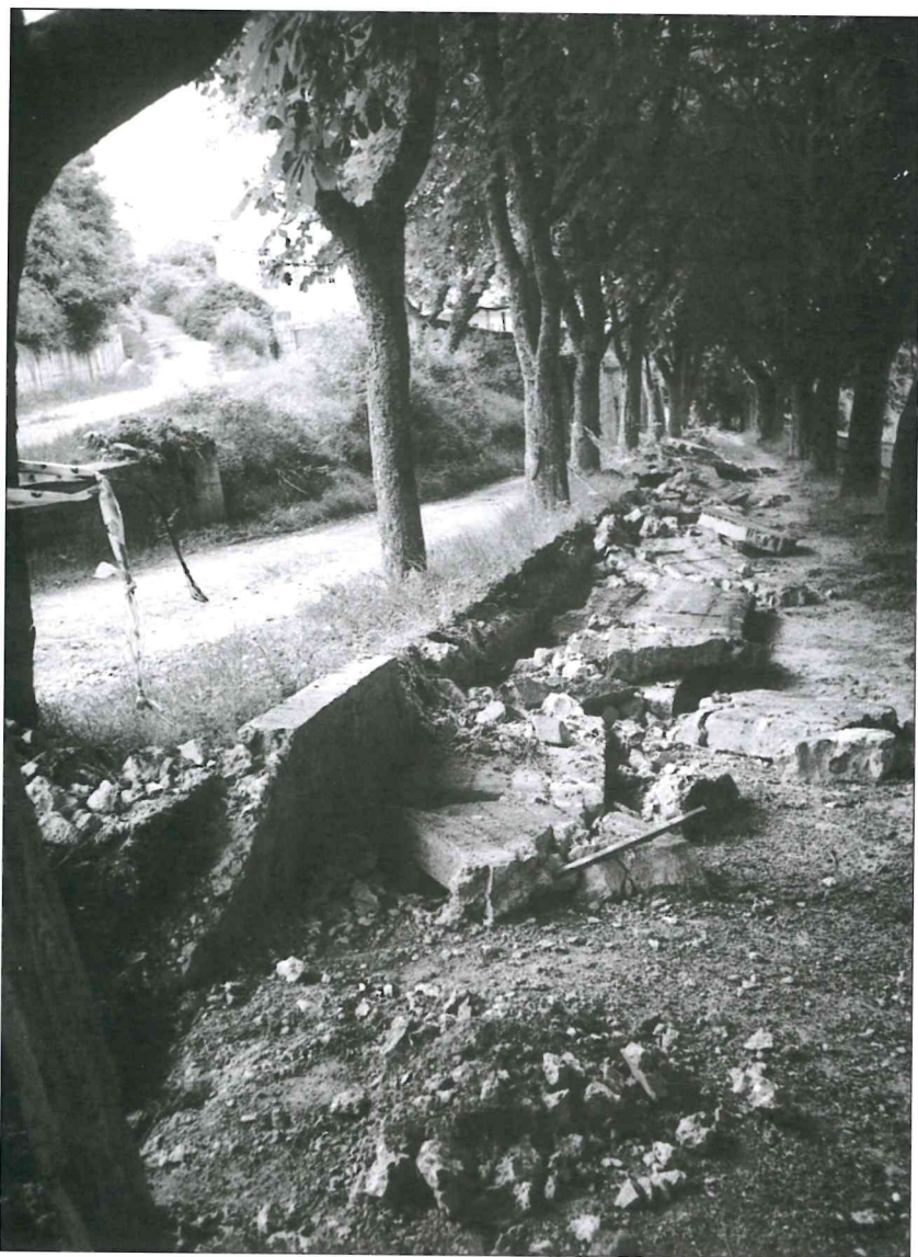
Estado del muro del Paseo antes de la restauración. Esperamos que esté ultimado antes del año próximo.
